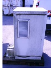
Systèmes d'alimentation et de contrôle des éclairages
